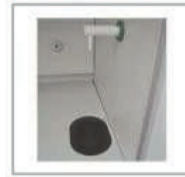
Grifo de agua, bacha/lavadero
