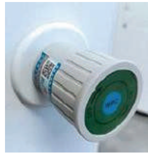
Válvula de control de flujo de suministro de agua
