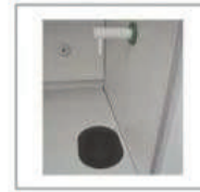
Grifo de agua, bacha/lavadero
