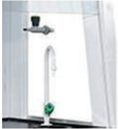
Grifos de agua y gas Bacha de agua
