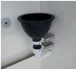
Pileta de agua
