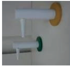
Grifos de agua y gas
